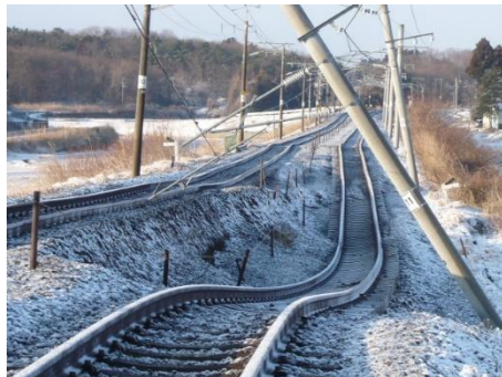
東日本大震災の被災状況（東北本線）
