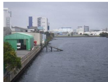
貯木場 (老朽化した護岸)
