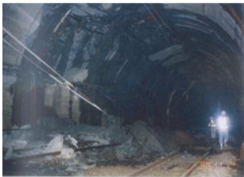
覆工アーチ部の崩落 1)
