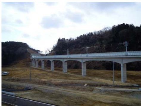
線路付替え終点付近。 手前が旧線路跡。高架橋奥があお ば通り方、右が石巻方。線路はま ちづくり計画に合わせ、丘陵地 に付替え。駅は地平部から約 500m山 側へ移設。切取り部奥が野蒜駅。
