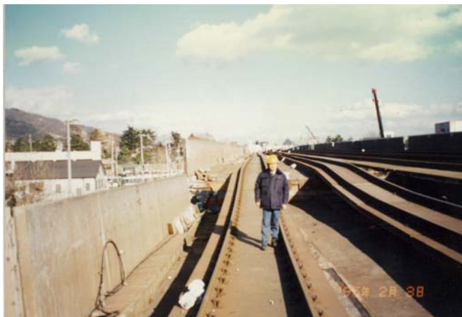
地震により1m落下した高架橋上：阪神大震災
