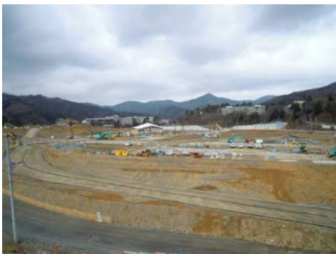
地域を嵩上げし、約 150m 山側 へ移設して構築の女川駅 (画面中央奥)
